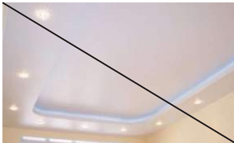
Плохо Многоуровневые гипсокартонные конструкции
